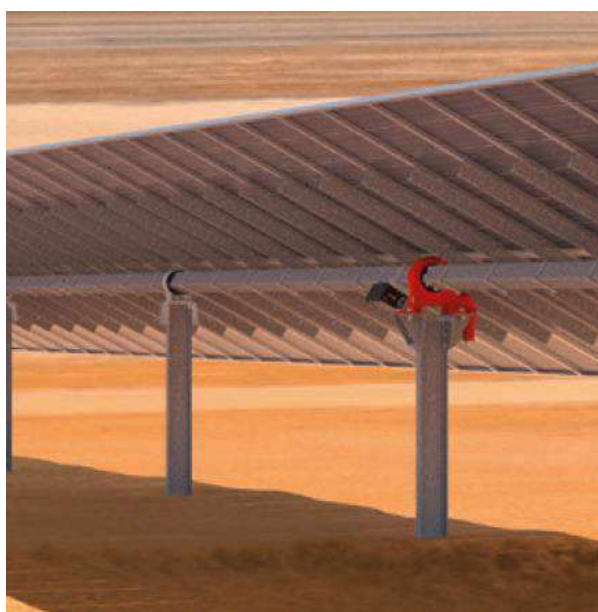
Figura 4. Inseguitori solari monoassiali.
