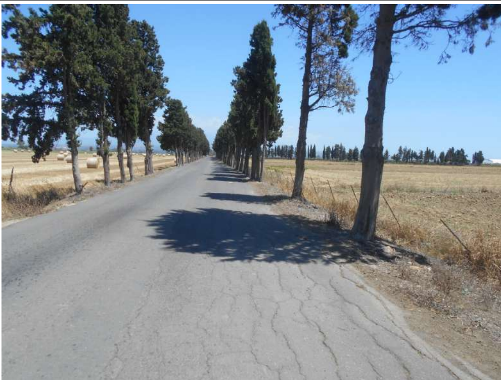
UR4 CAVIDOTTO INTERRATO SU VIABILITÀ PRIVATA S.N. D'ACCESSO AD AZIENDE PRODUTTIVE. VISTA DA SUD. (LOC.TÀ MANDRAZZE)
