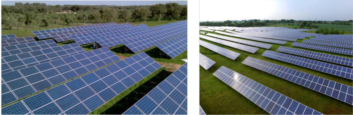
Figura 89 - Esempi di impianto fotovoltaico
