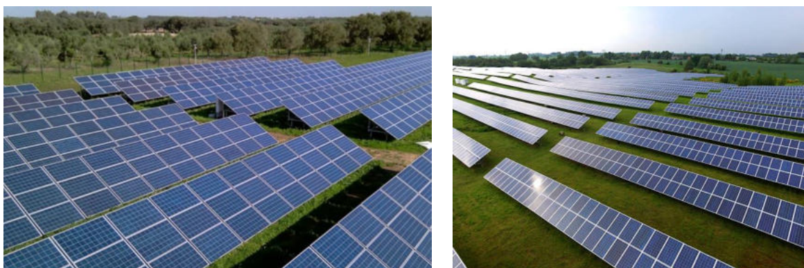
Figura 1 - Esempi di impianto fotovoltaico
