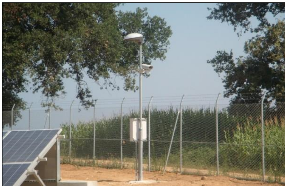
Figura 12 – Tipico palo di sostegno per illuminazione e videosorveglianza
