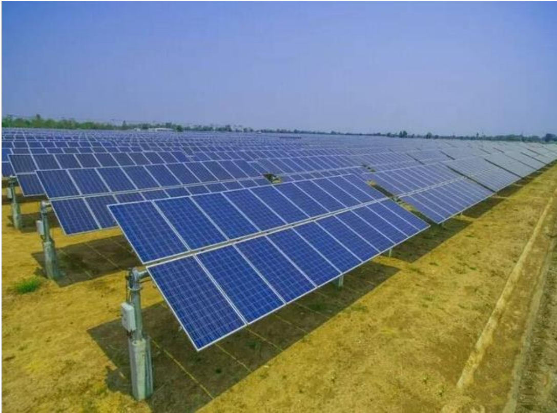
Figura 9 – Strutture di sostegno dei moduli "tracker"
