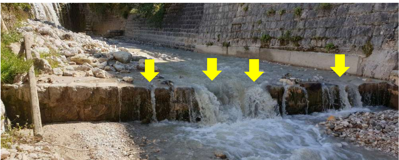
Figura 9.9 –Soglia di fondo danneggiata
