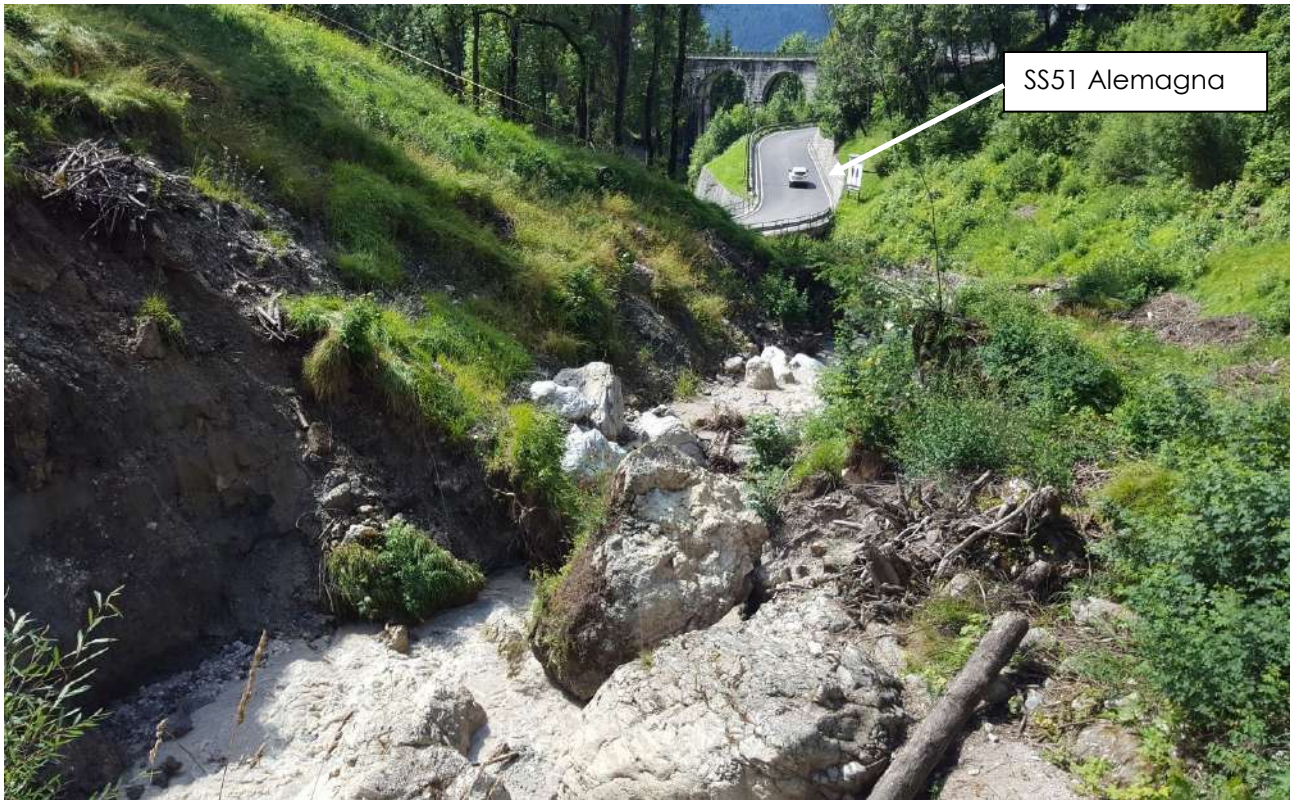
Figura 2.25– vista a valle della briglia crollata (Sopralluogo Luglio 2018)
