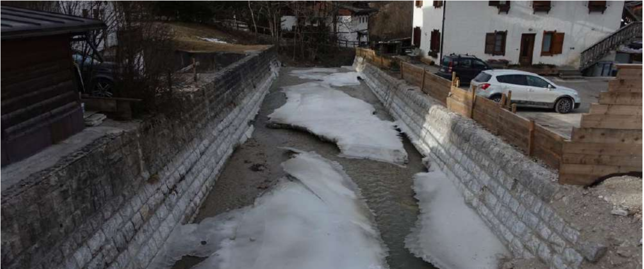
Figura 2.12– vista verso valle del ponte sulla SR48 (rilievo Dicembre 2018) in destra idrografica protezioni con assi in legno punto dove si verifica fuoriuscita di portata.
