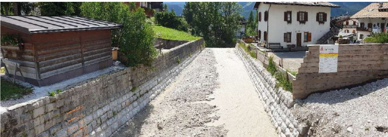
Figura 2.13– vista verso valle del ponte sulla SR48 (sopralluogo Luglio 2019) in destra idrografica protezioni con assi in legno punto dove si verifica fuoriuscita di portata.
