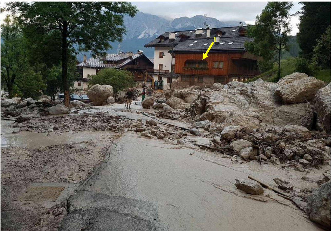
Figura 6.3 – Evento del 4-5 Agosto 2017 – segni della fuoriuscita di portata in sinistra idrografica a monte del ponte della strada comunale non rilevata dai modelli
