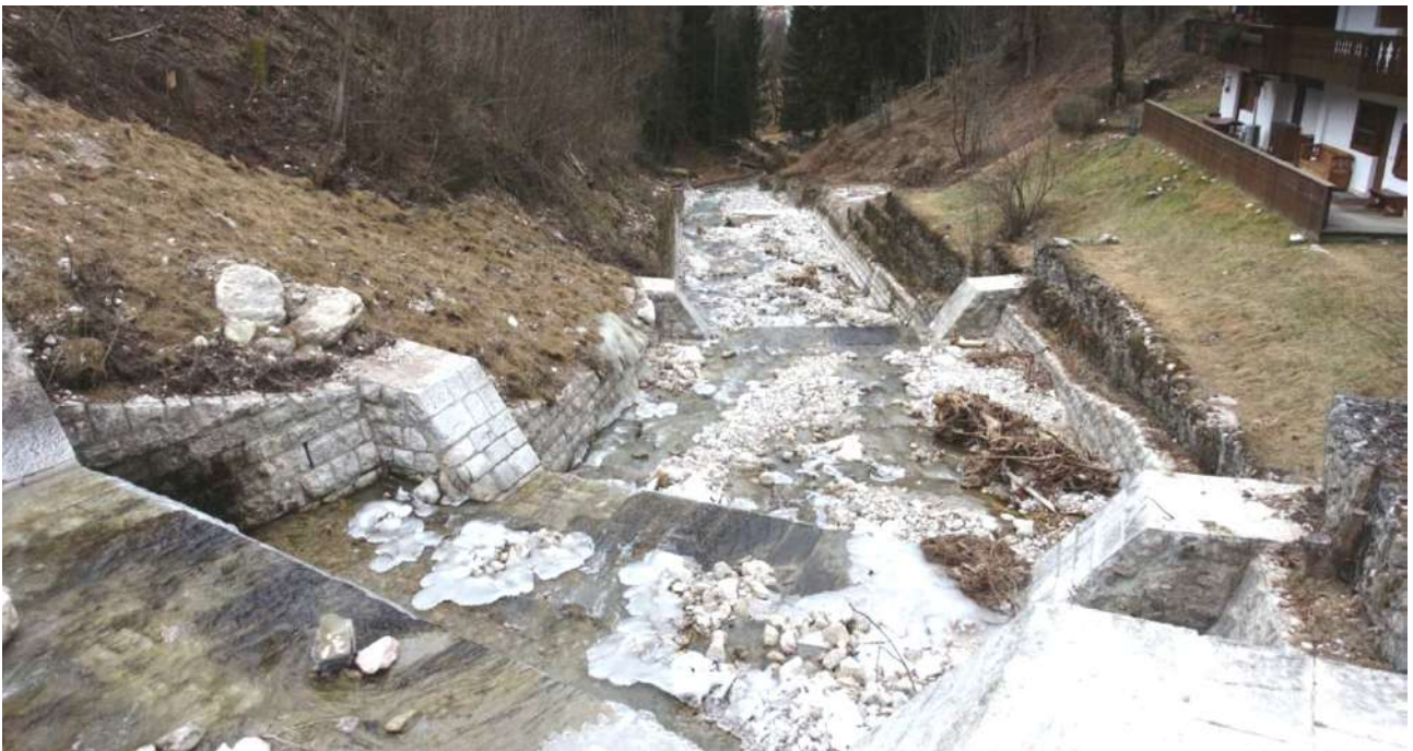
Figura 2.24– Inquadramento dell'area –tratto con una serie di briglie in successione a valle del ponte per Pecol ( rilievo Dicembre 2018)
