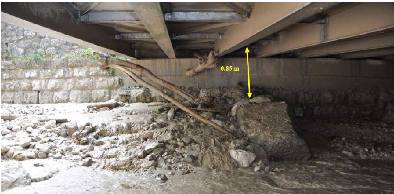
Figura 8.11 – Trovante rinvenuto al di sotto dell'attraversamento in seguito all'evento "Vaia" (Foto Ing. Roland Bernardi 2018)
