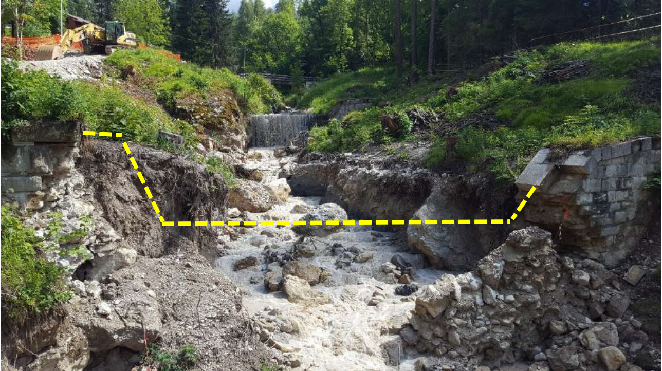
Figura 1.1 – foto 1 Sagoma della briglia crollata a valle della passerella pedonale che collega via Ria De Zeto alla località Pecol (Studio API LUGLIO 2018)
