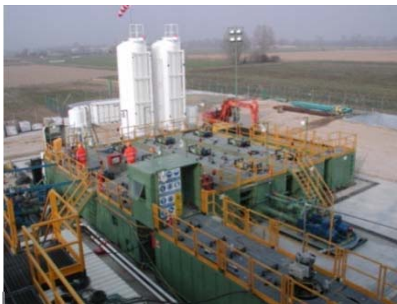
Figura 3-36 Impianto di perforazione HH220: circuito fango
