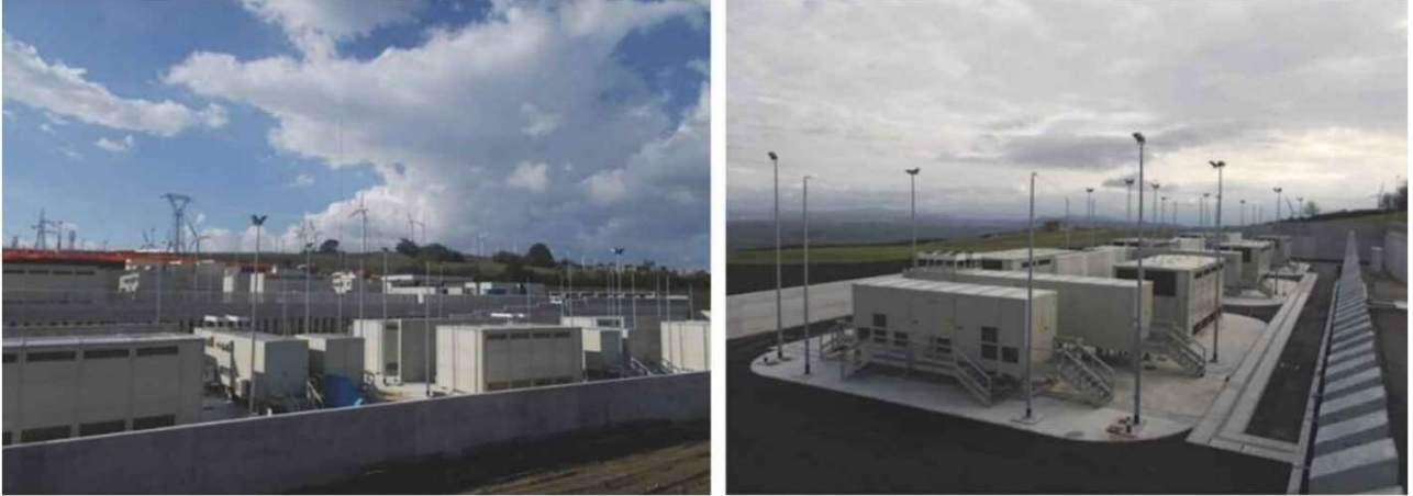
Figura 3 - Alcune fotografie dell'installazione energy intensive di Ginestra presa come riferimento.
