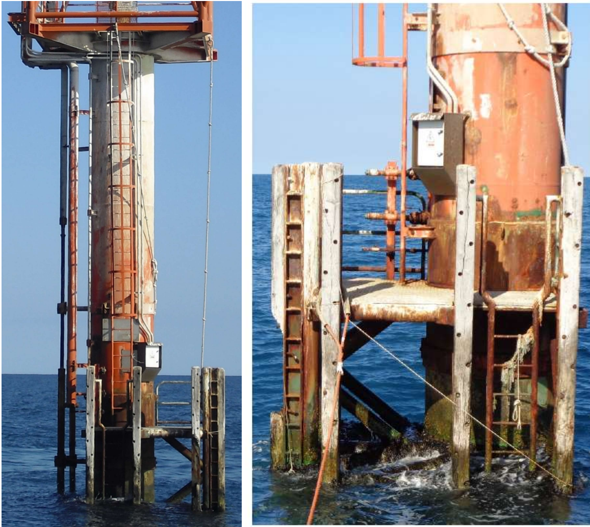
Figura 1-3: Monotubolare e risalite delle condotte sottomarine (a sinistra) e vista generale dell'imbarcadero (a destra) (fonte: Eni).
