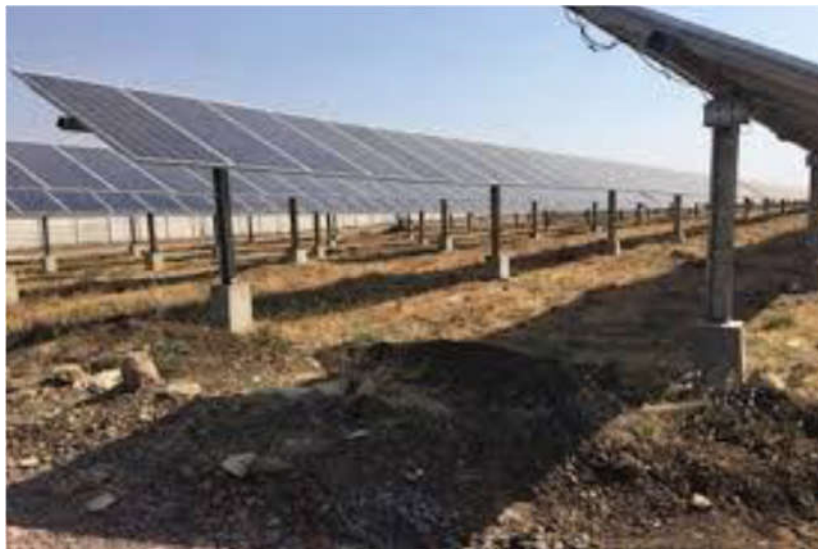
Figura 3 – Esempio di impianto fotovoltaico con fondazioni ottenute mediante perforazione del terreno e successiva creazione del palo di fondazione con getto di cemento.
