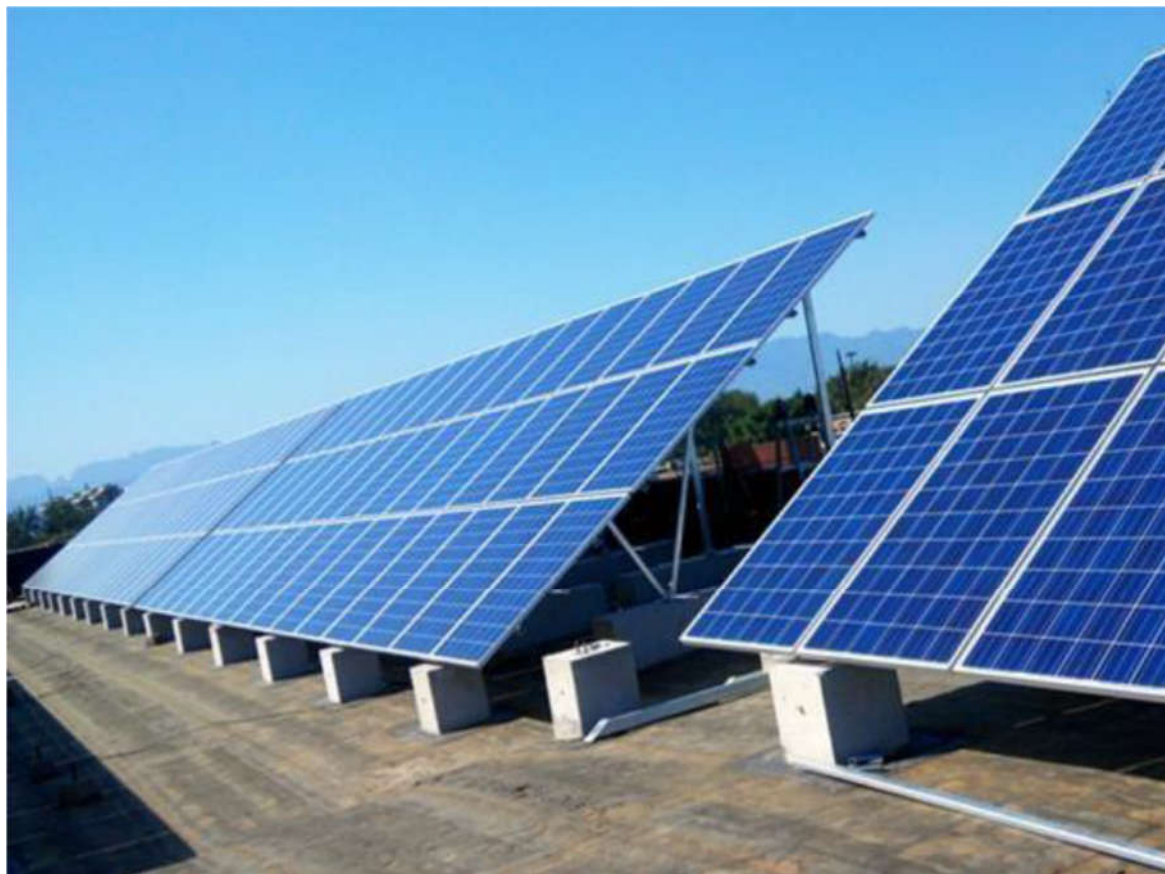
Figura 12 – Esempio di impianto fotovoltaico con fondazioni formate da zavorre costituite da plinti in cemento.
