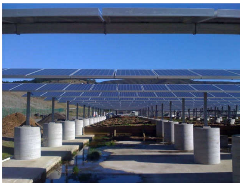
Figura 11 - Esempio di impianto fotovoltaico con fondazioni formate da zavorre costituite da plinti in cemento.
