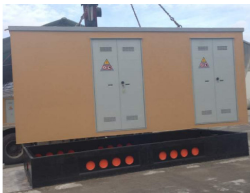
Fig.7- cabina tipo prefabbricata
