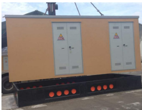
Fig.7- cabina tipo prefabbricata
