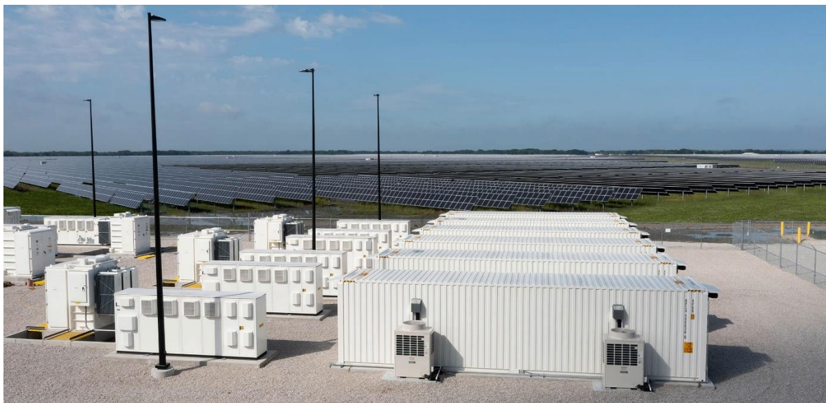
Esempio di impianto BESS
