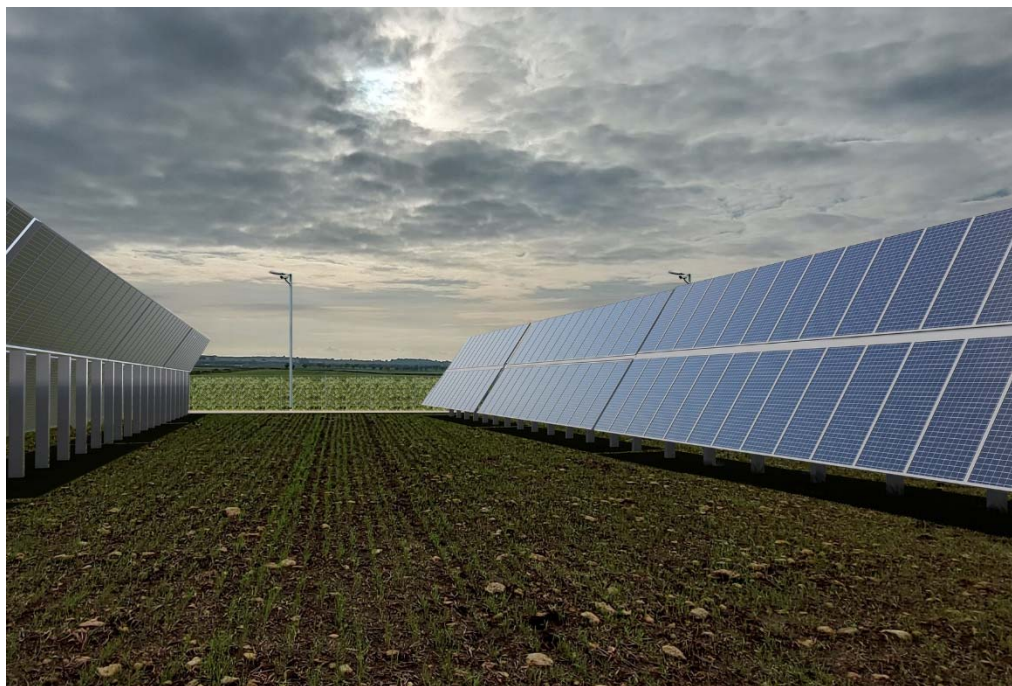
Figura 20 – Foraggio tra le file dei trackers e sotto le strutture
