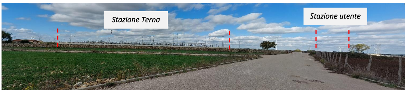
Figura 14 - Stazione Elettrica Terna e Stazione Utente
