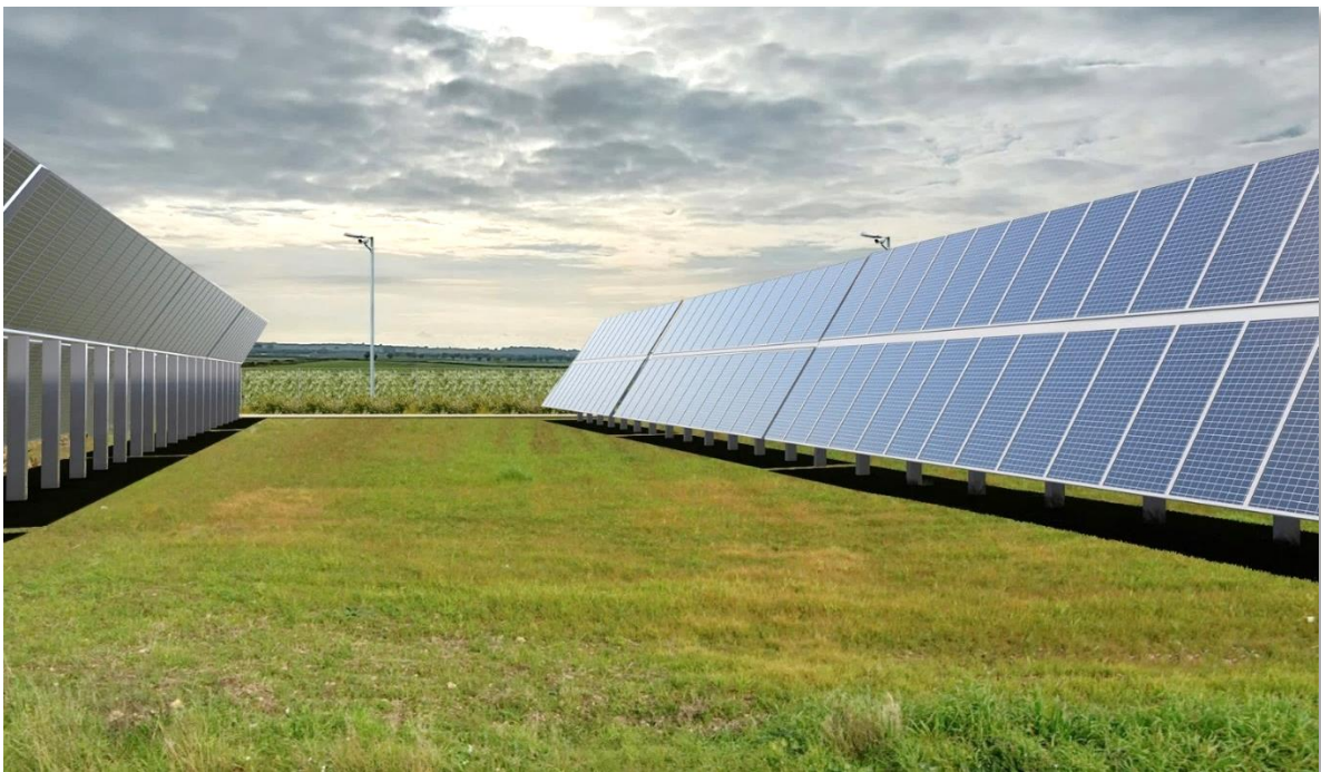
Figura 76 - Fotoinserimento con Foraggio tra le file dei pannelli fotovoltaici
