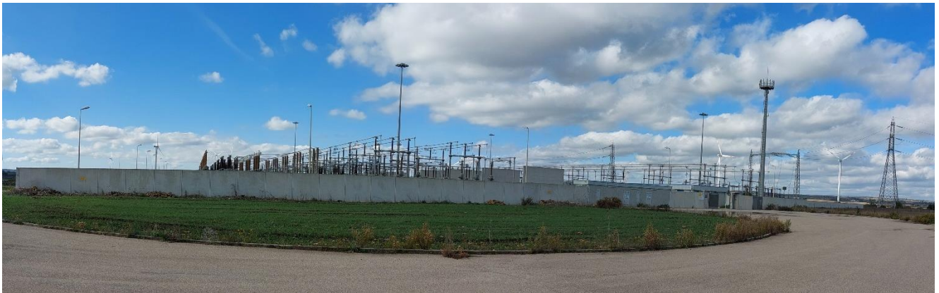
Figura 15 - Stazione Elettrica Terna
