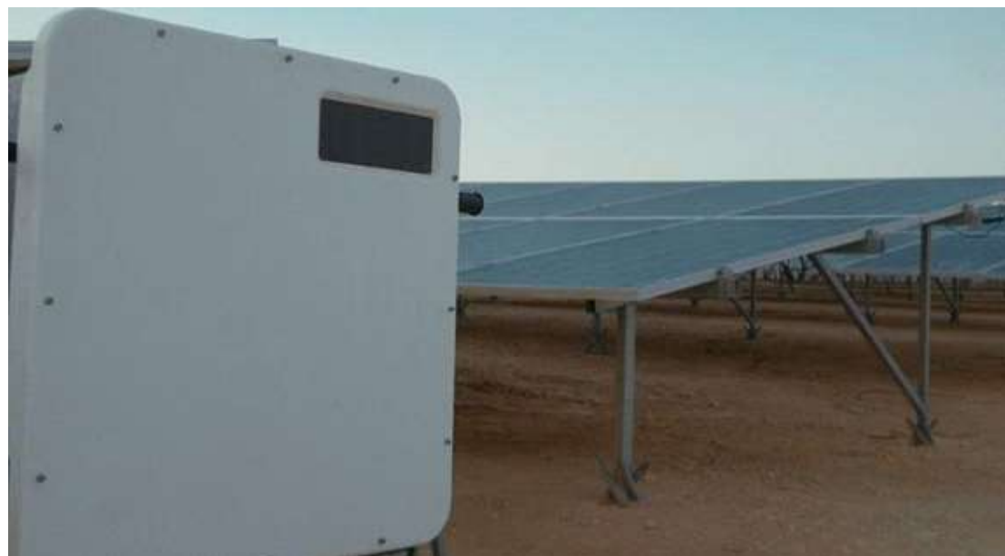
Inverter con pannelli – foto esemplificativa
