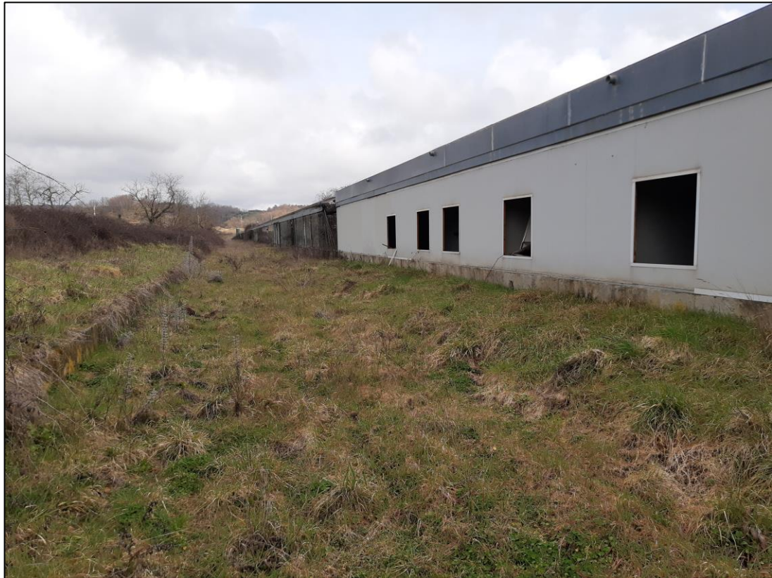
Figura 2.1.k Particolare esterno delle serre in disuso insistenti all'interno del polo produttivo agro-energetico (punto di vista da Sud verso Nord lato Occidentale)
