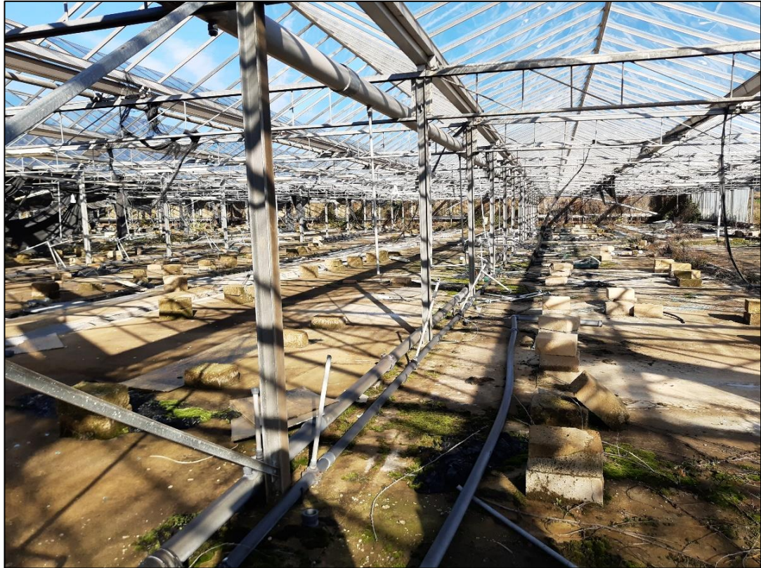
Figura 2.1.m Particolare interno delle serre in disuso insistenti all'interno del polo produttivo agro-energetico
