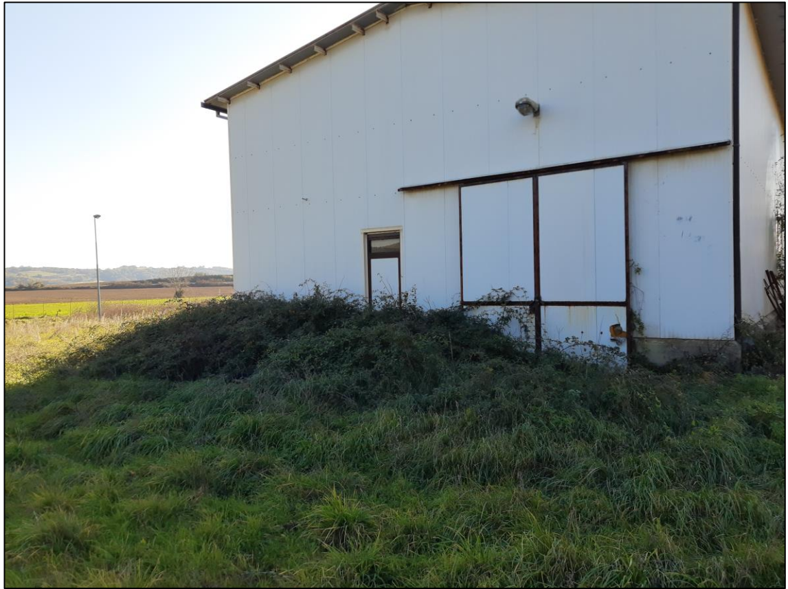
Figura 2.1.e Particolare esterno edificio magazzino in disuso presenti all'interno del polo produttivo agro-energetico
