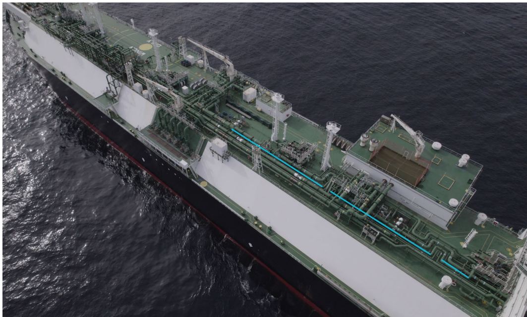
Figura 18 - Fotografia FSRU Tundra – linee di ricircolo serbatoi GNL
