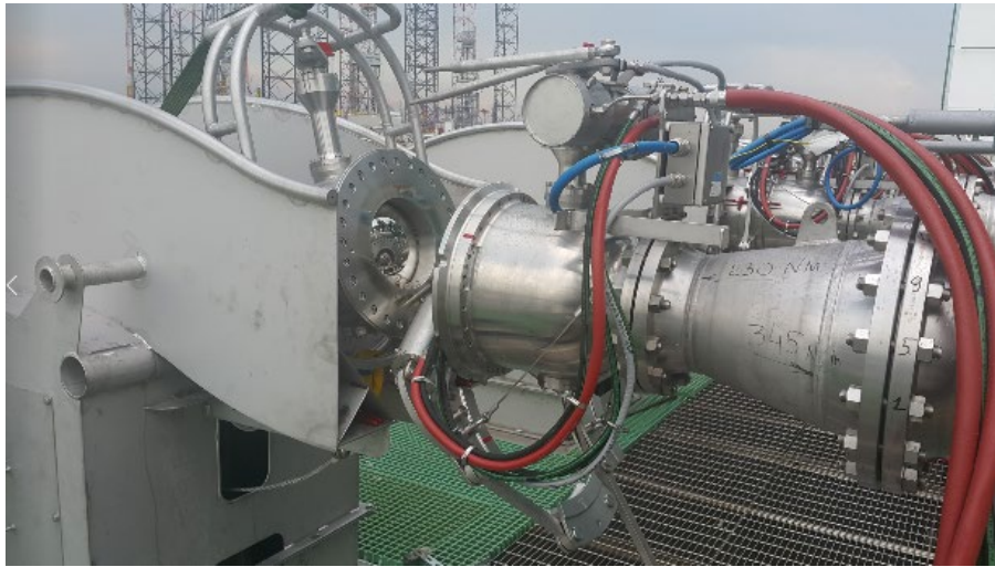
Figura 47 – Dettaglio fotografico accoppiamento manichette
