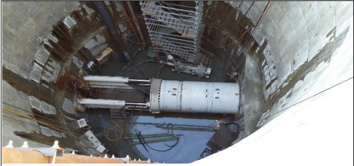
Figura 4.22: Interno di un pozzo di lancio di un MT
