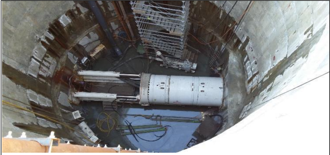
Figura 2.23: Interno di un pozzo di lancio di un MT
