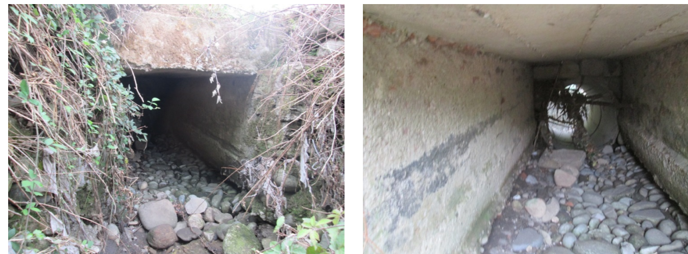
Figura 3.3. Tombino scatolare di attraversamento della poderale.
