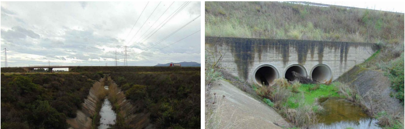
Figura 4 – Dettagli fotografici del canale Imboi e di un attraversamento che sarà demolito
