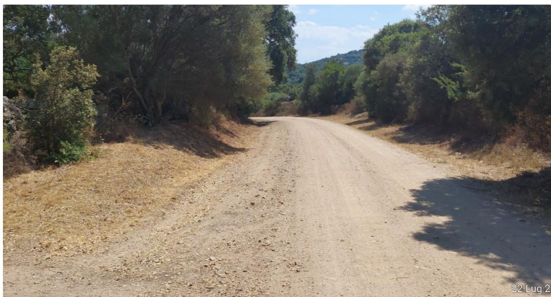
Figura 5.6 – Esistente viabilità in adeguamento lungo l'accesso alla postazione TL-04 facente parte della viabilità di progetto
