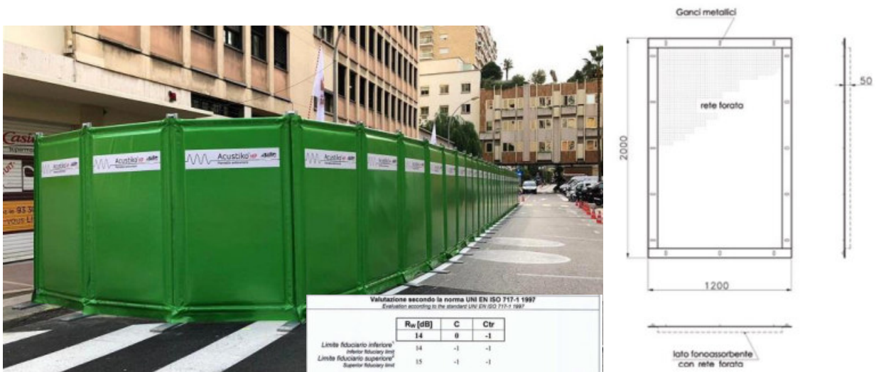
Fig.15: Caratteristiche tecniche e dati di abbattimento della barriera antirumore temporanea di cantiere
