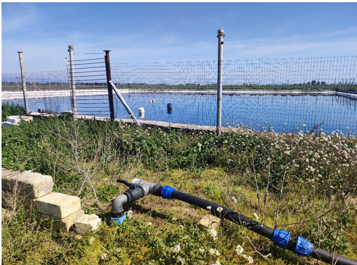
Vasca irrigua aziendale - gruppo elettropompa filtro
