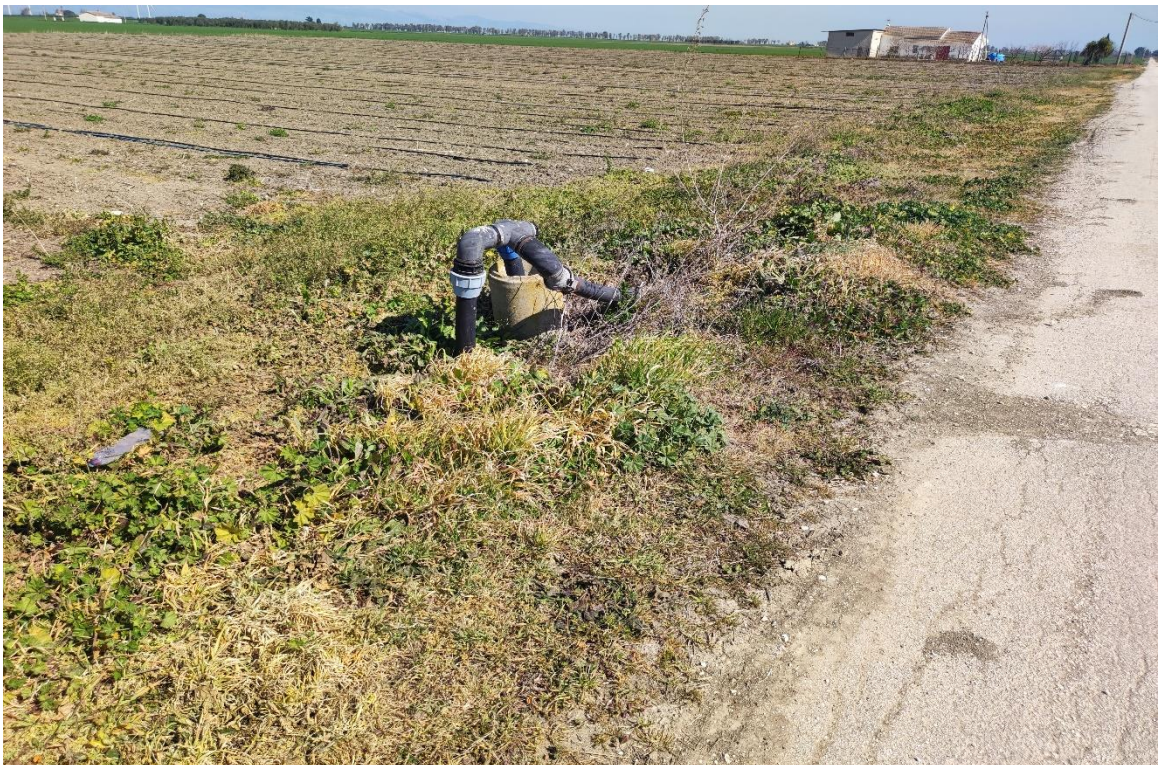
Idrante rete irrigua aziendale
