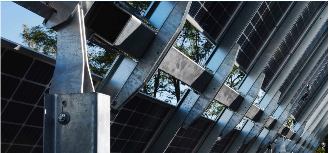
Immagine 7 – Esempio di struttura di sostegno dei pannelli fotovoltaici
