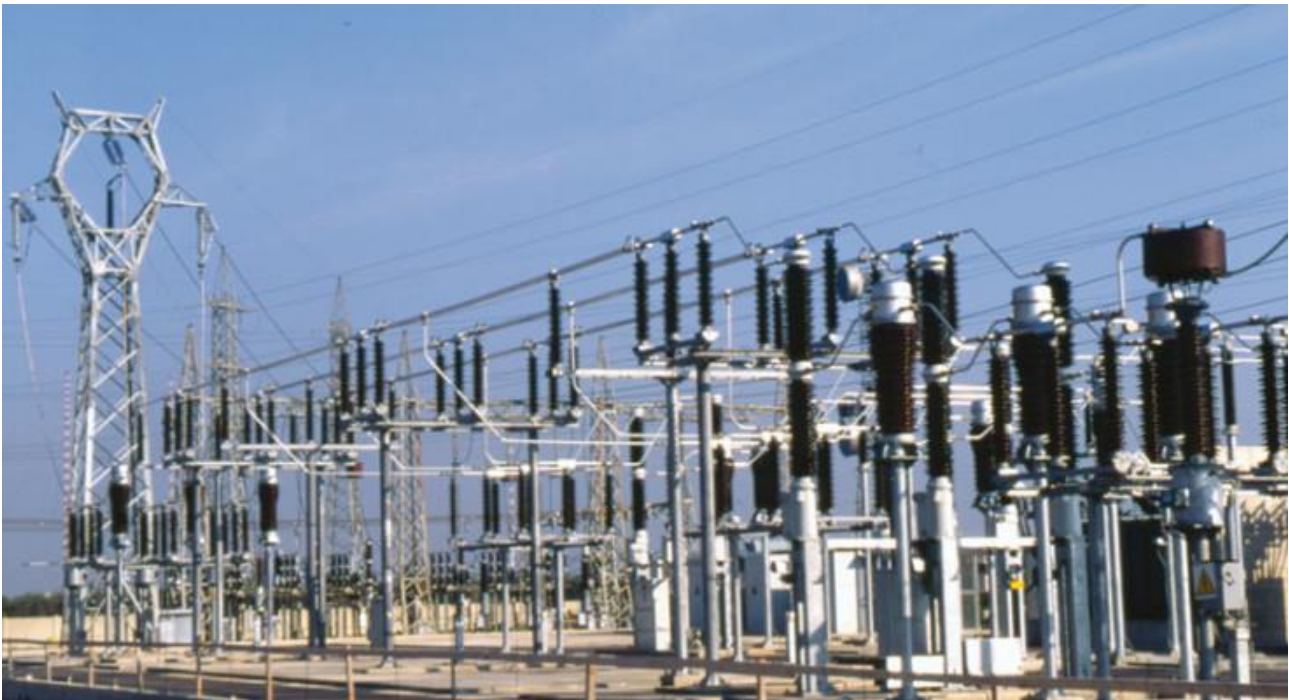
Figura 2.33 – Esempio di aspetto di stazione AT – RTN, (fonte Web, free license)
