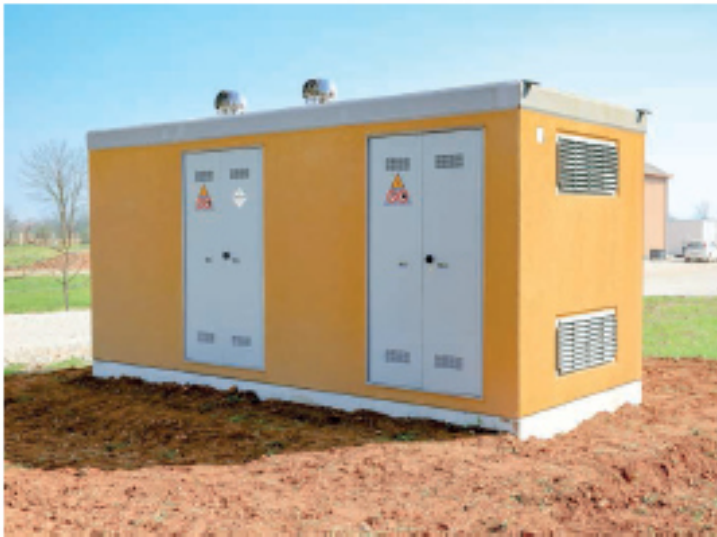
Figura 5.1 Vista Cabina quadri AT
