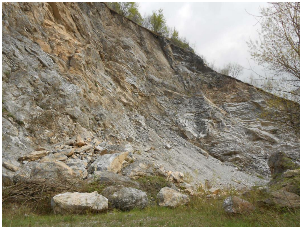
Fig. 8: Area interessata da fenomeni di dissesto in roccia
