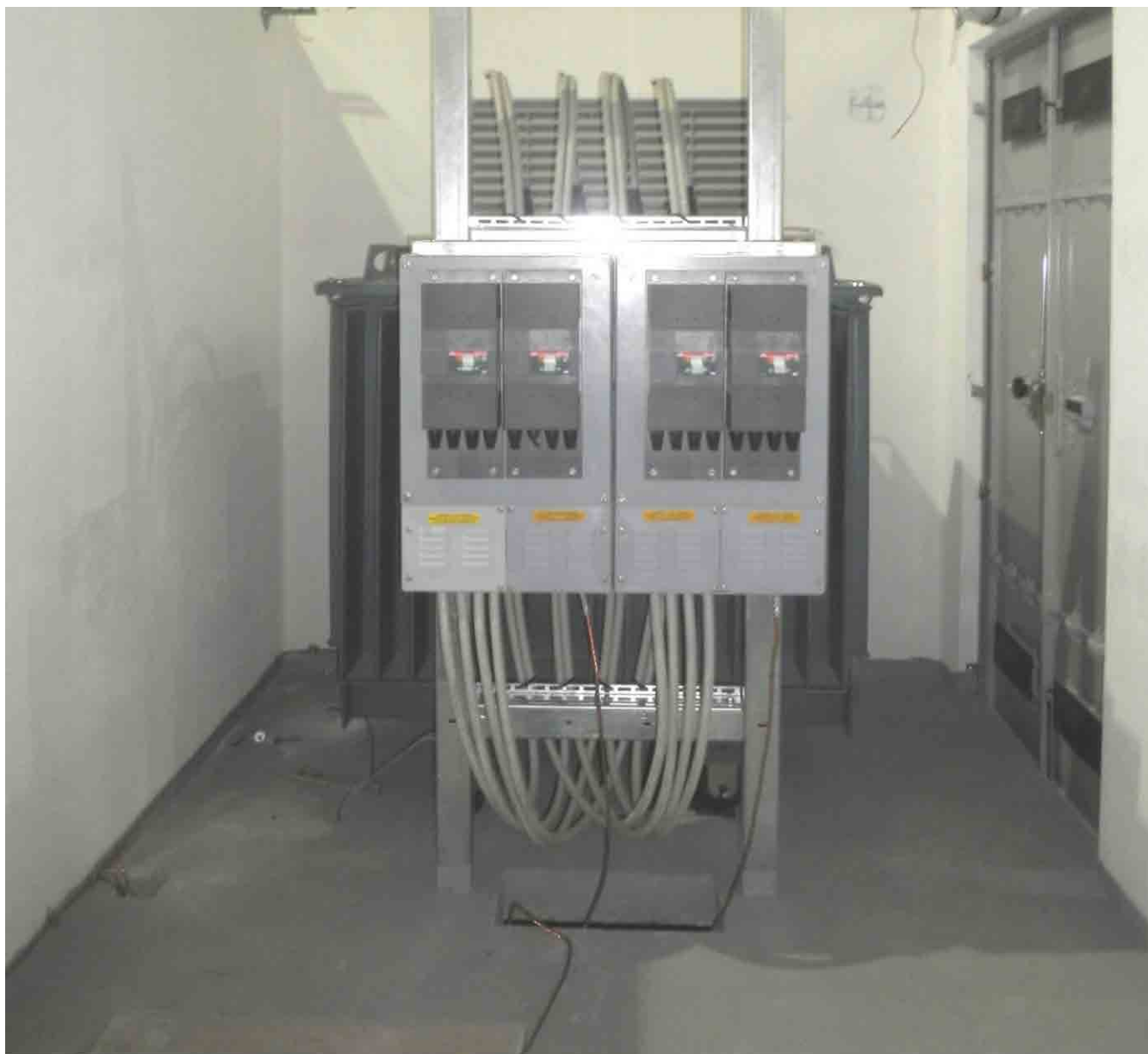
Esempio quadro BT installato
