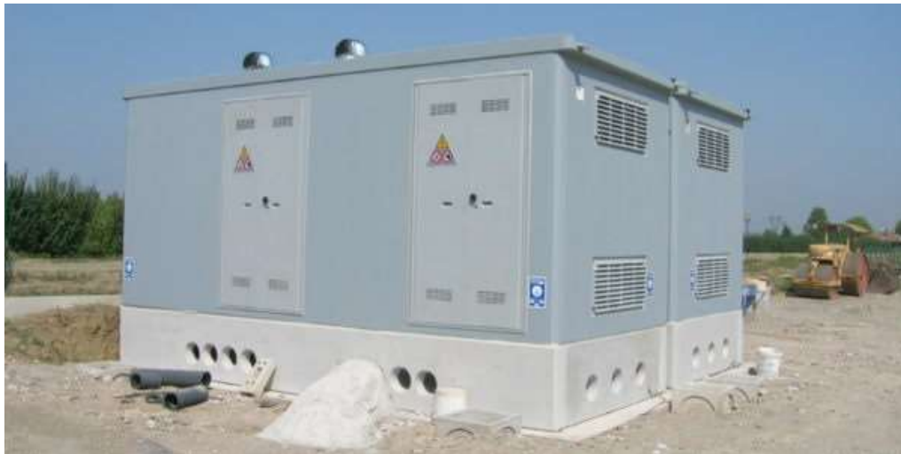
Monoblocco prefabbricato (cabina di sottocampo) tipo Standard DG 2061
