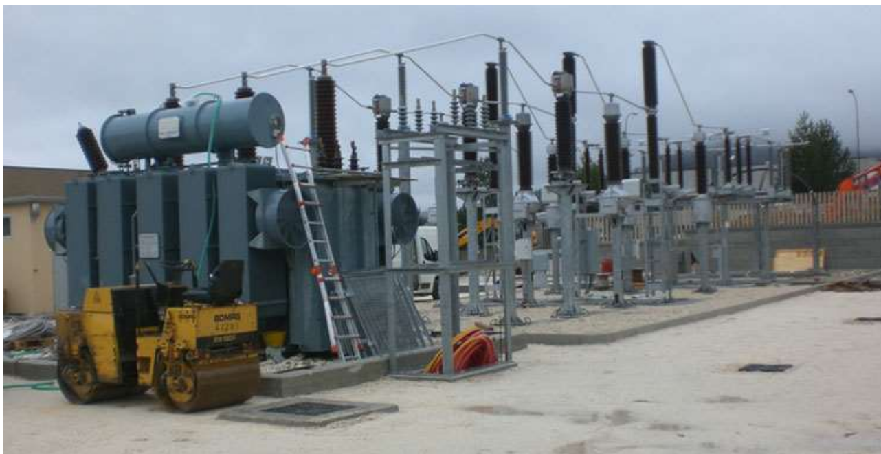
Cabina Primaria di elevazione 30/150 kV
