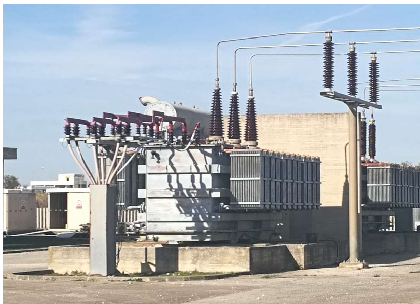
Tipico trasformatore di potenza AT/MT ONAN
