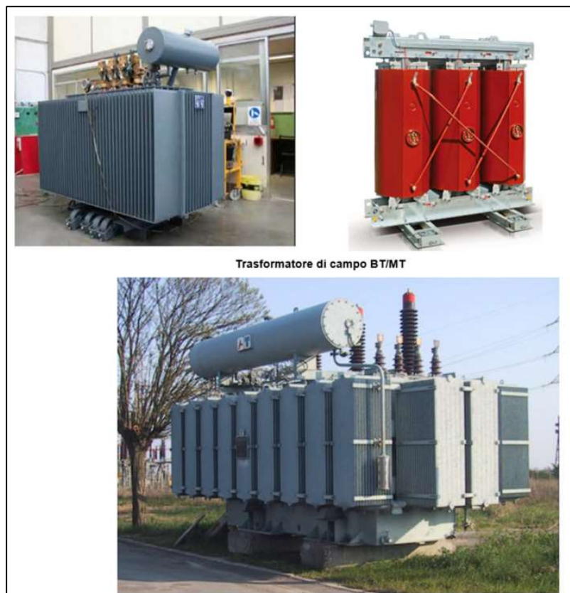
Figura 19: Trasformatore di campo
