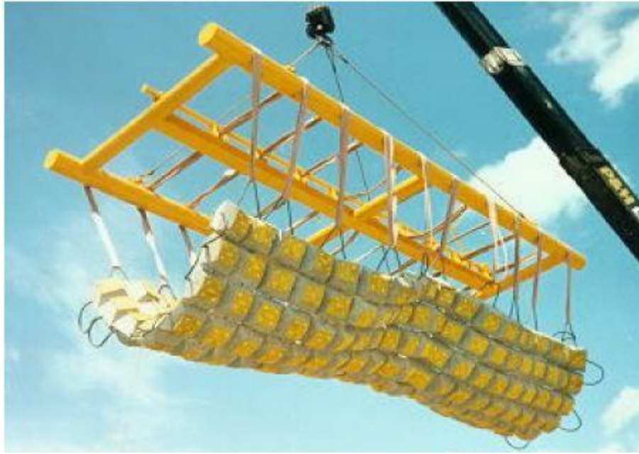
Figura 5: immagine del sollevamento del materasso in calcestruzzo da cui si evince anche la tessitura
