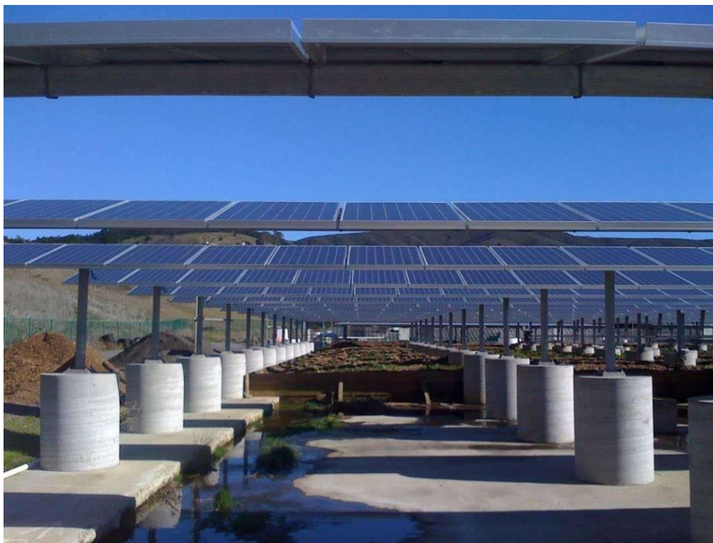
Fig. 58 _ Esempio di impianto fotovoltaico con fondazioni formate da zavorre costituite da plinti in cemento
