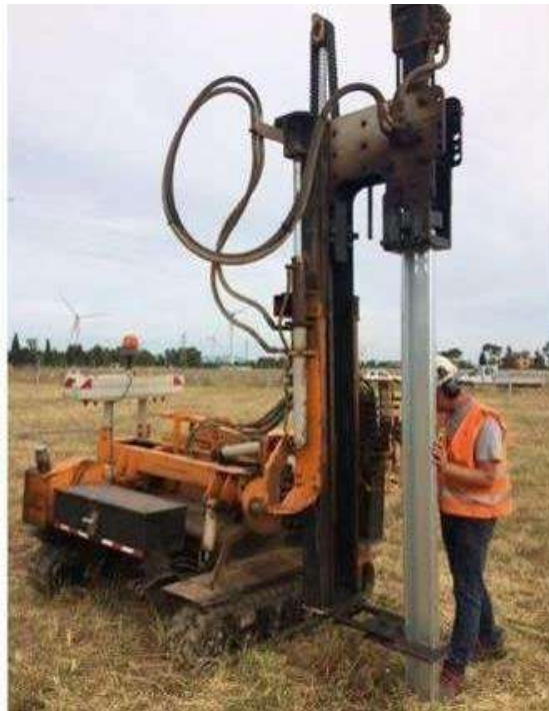
Fig. 56_ Esempio di supporto costituito da palo in acciaio infisso direttamente nel terreno mediante battipalo
