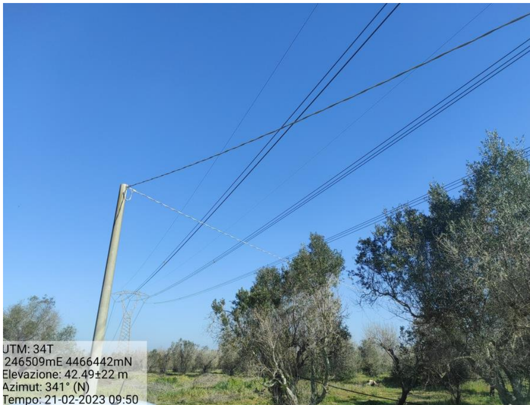
Figura 25 - Linea elettrica AT - Foto 7
