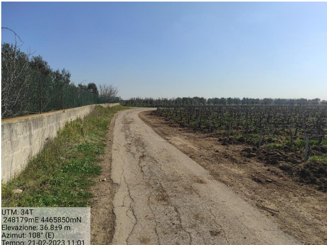
Figura 79 - Presenza di muretto di confine in cls - Foto 65
