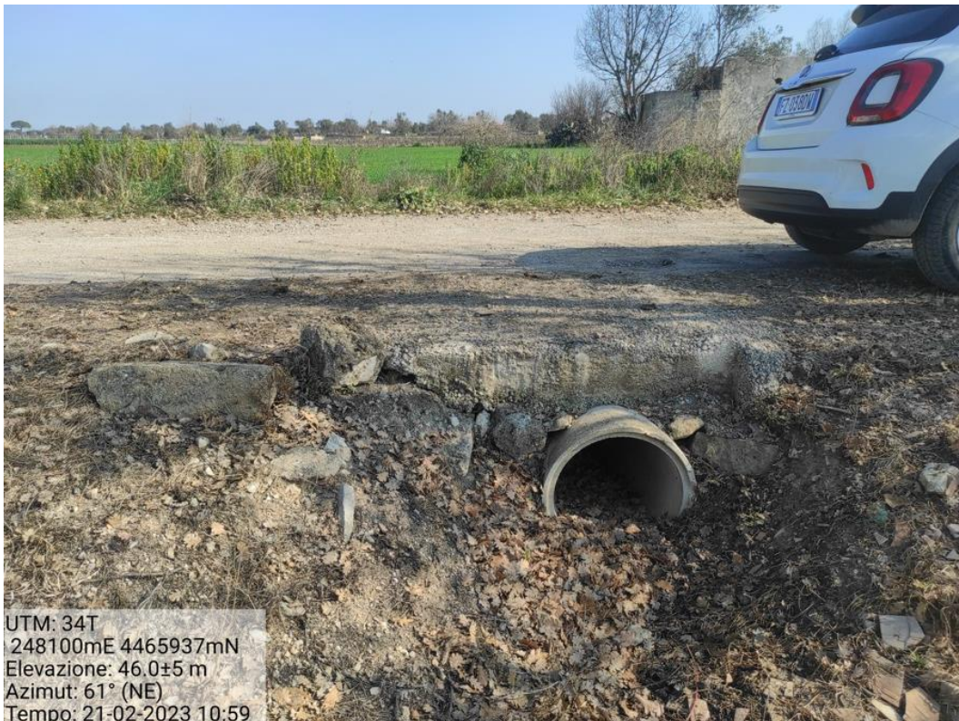
Figura 77 - Interferenza con attraversamento stradale – Foto 61
