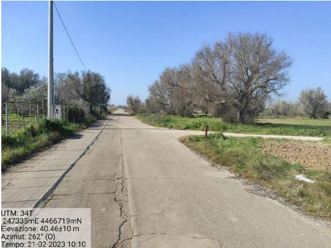
Figura 118: Interferenza con linea BT lungo strada di accesso (Foto 21 di Figura 117)
