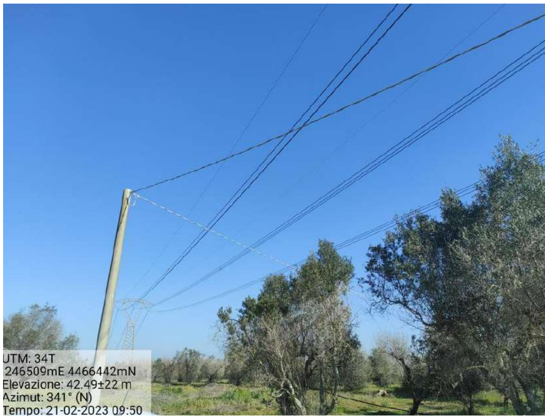
Figura 115: Linea elettrica AT (Foto 7 di Figura 111)
