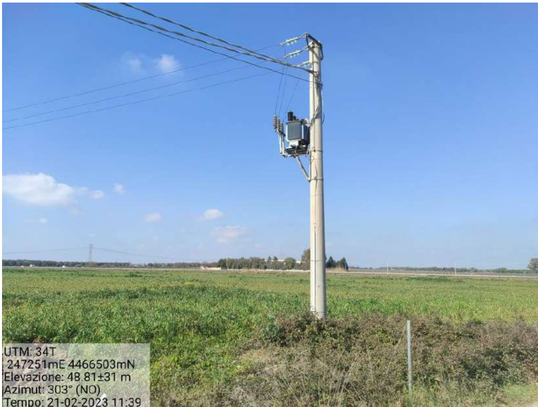
Figura 121: Interferenza linea elettrica MT (Foto 91 di Figura 119)
