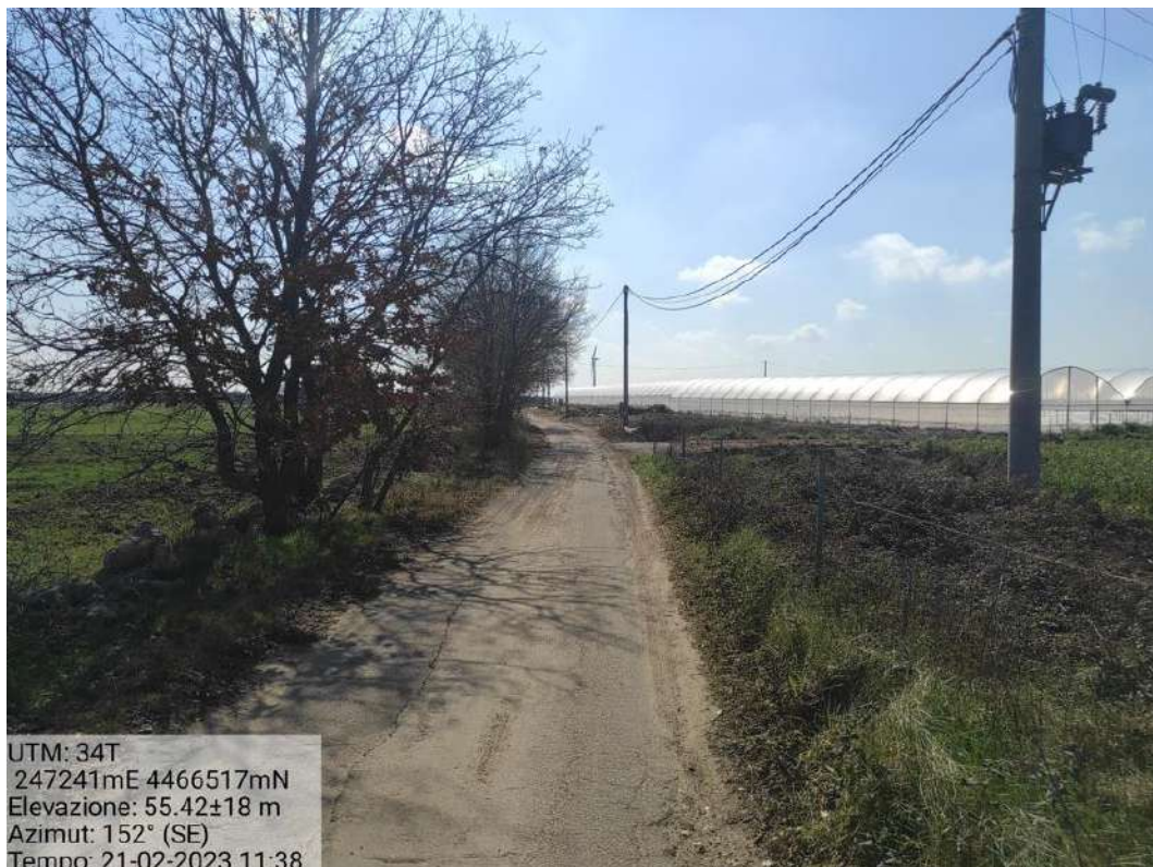
Figura 120: Interferenza con linea elettrica BT lungo viabilità esistente da adeguare (Foto 89 di Figura 119)
