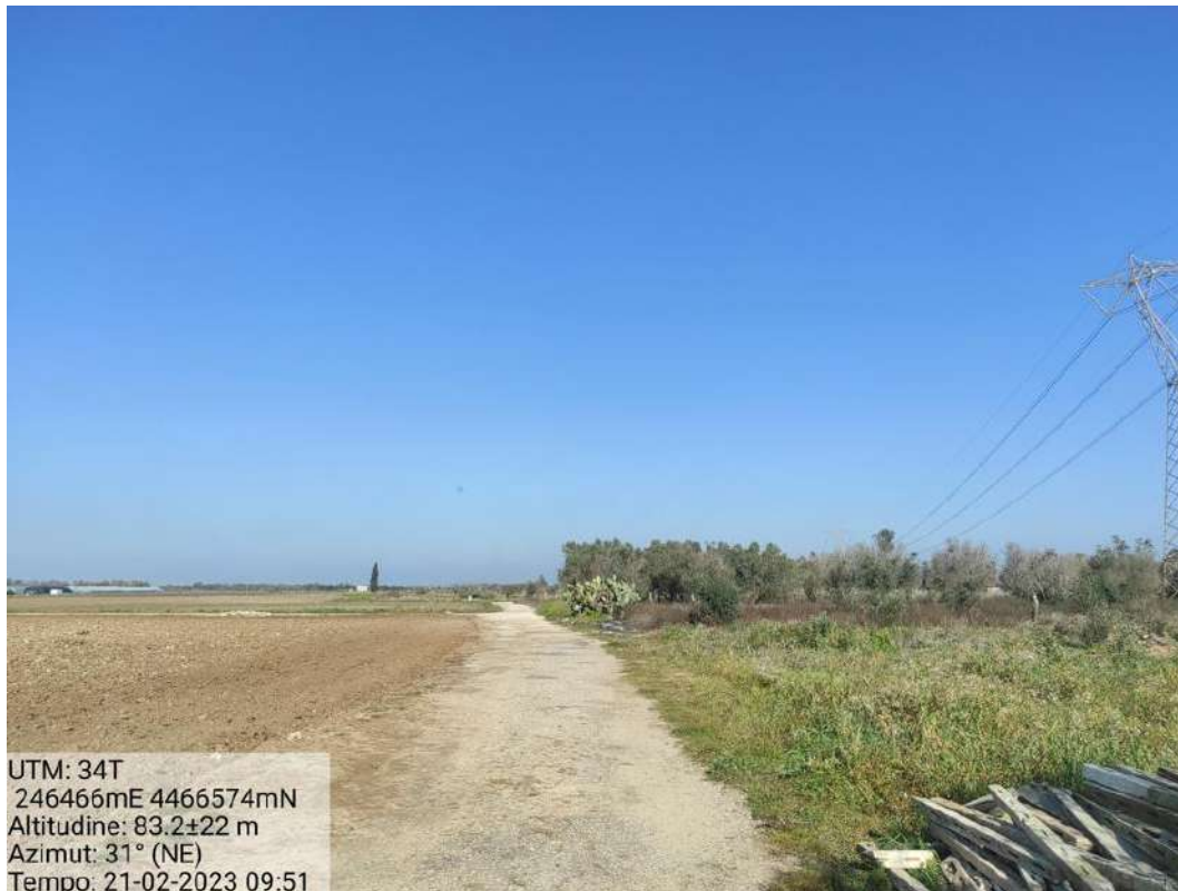
Figura 116: Linea elettrica AT (Foto 9 di Figura 111)
