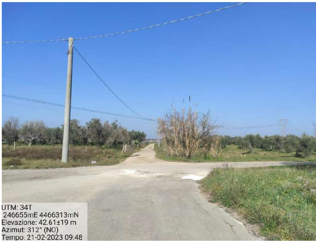
Figura 113: Linea elettrica BT lungo viabilità di accesso per A3 (Foto 6 di Figura 111)
