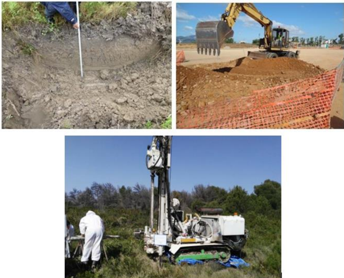
Figura 25: Operazioni di caratterizzazione ambientale da scavo mediante escavatore meccanico (sopra) e da sondaggio (sotto).
