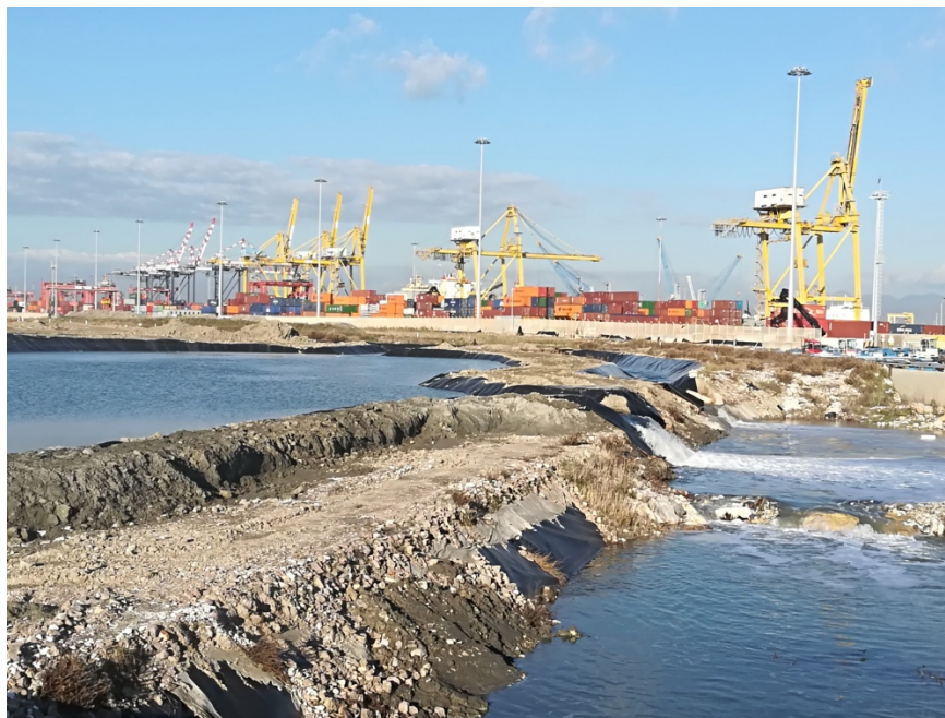
Particolare del canale di raccolta delle acque provenienti dalla seconda vasca di colmata nel punto di sversamento nel bacino di decantazione prima dello sfioro nella Darsena Petroli
