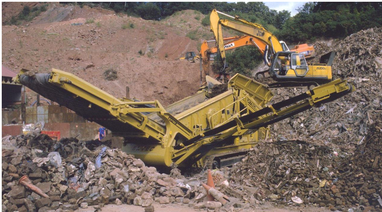
Foto 3: impianto di vagliatura Extec
