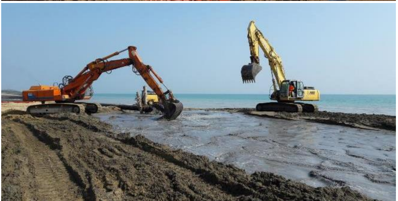
Figura 2.5 - Sabbiodotto di Bibione in esercizio (HS marine, 2019)
