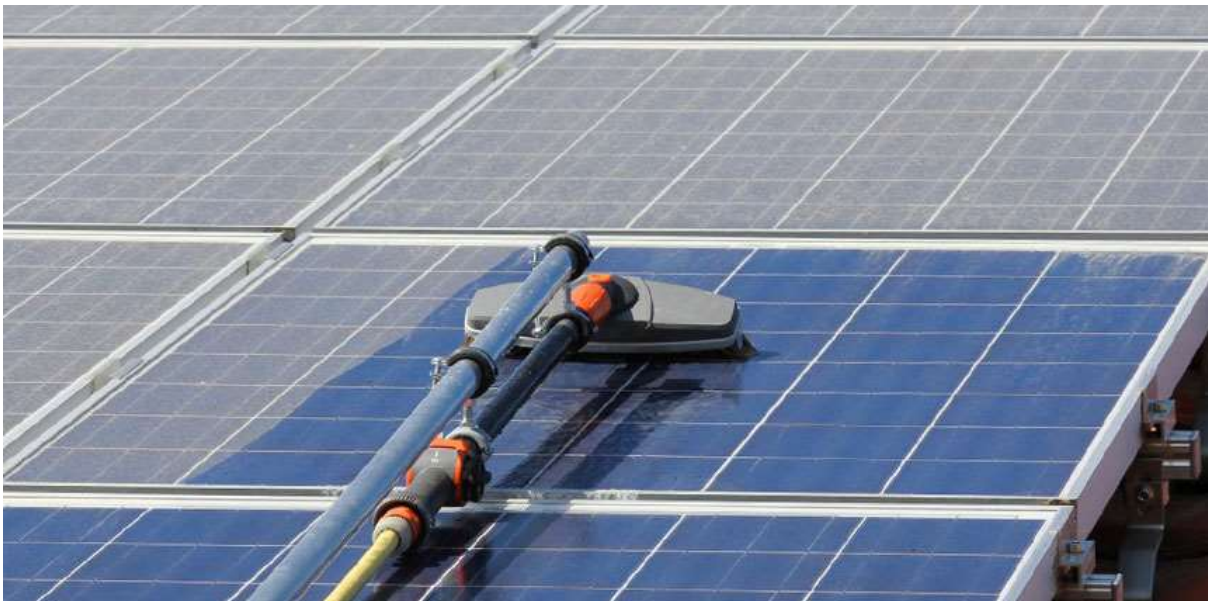
Figura 31- Esempio pulizia pannelli fotovoltaici
