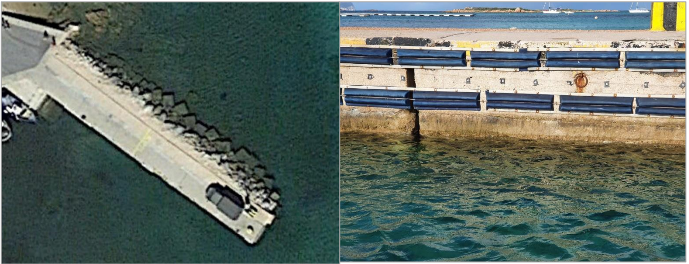
Figure 7 Foto dello stato attuale scogliera da rifiorire e giunto tipo da ripristinare
