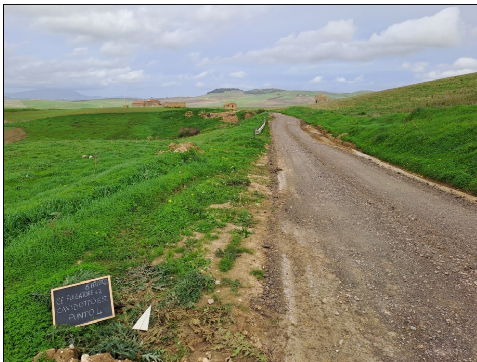
Fig. 29: Cavidotto esterno. Punto 4 – Tratto I
