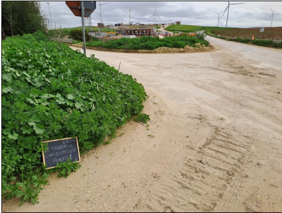
Fig. 26: Cavidotto esterno. Punto 1 – Tratto I
