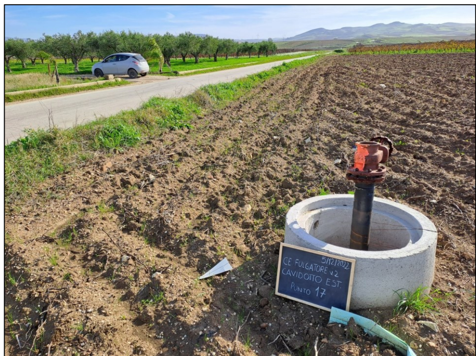
Fig. 45: Cavidotto esterno. Punto 17 – Tratto VII
