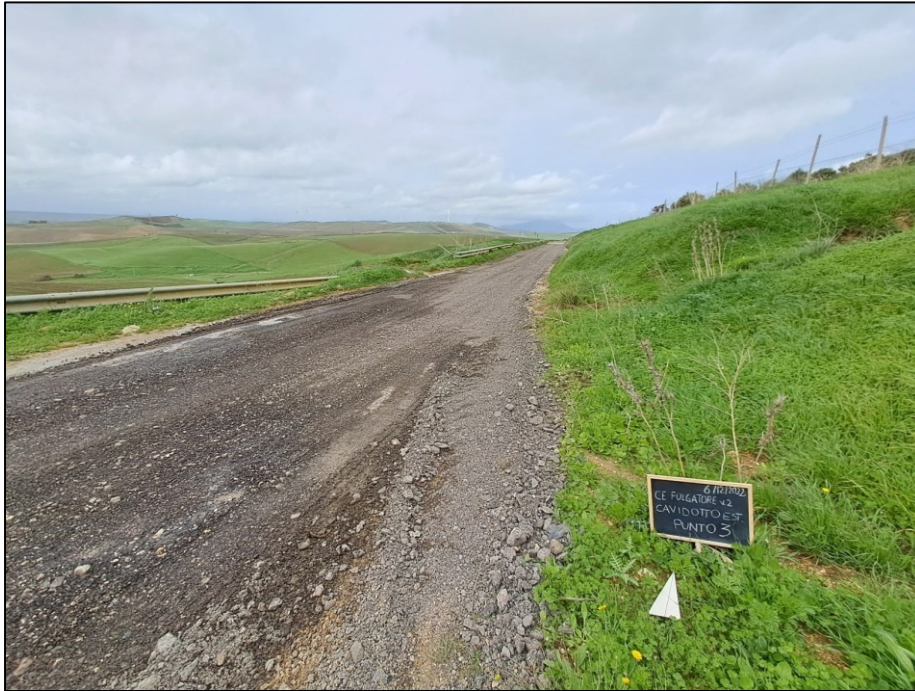
Fig. 28: Cavidotto esterno. Punto 3 – Tratto I
