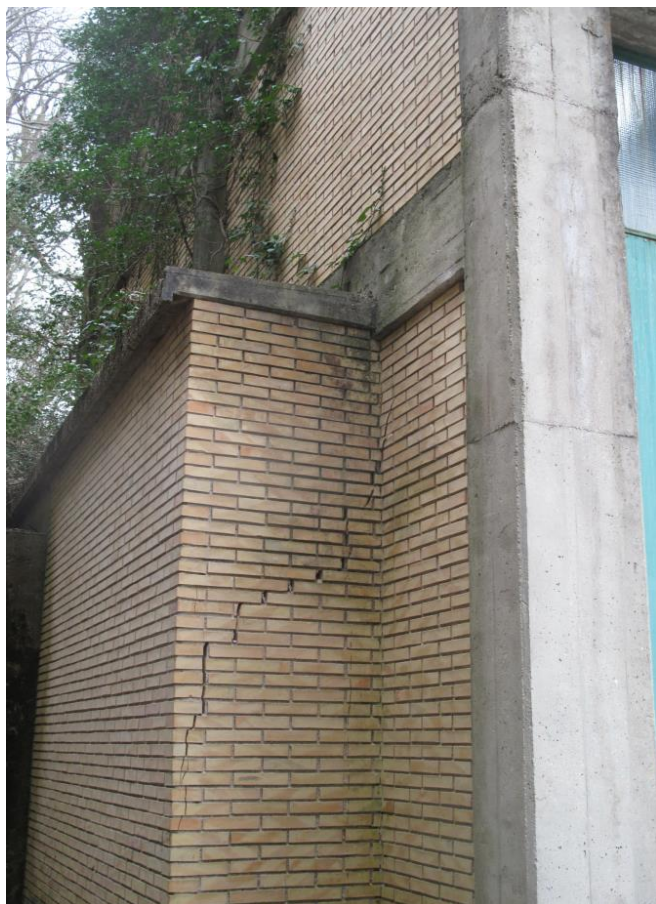
Figura 16: Lesione nel muro dell'edificio della camera a valvole dell'impianto Polverina
