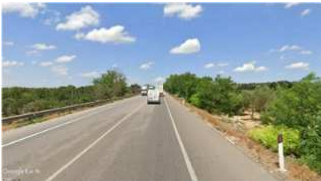
Scarpate non protette e terminale pericoloso
