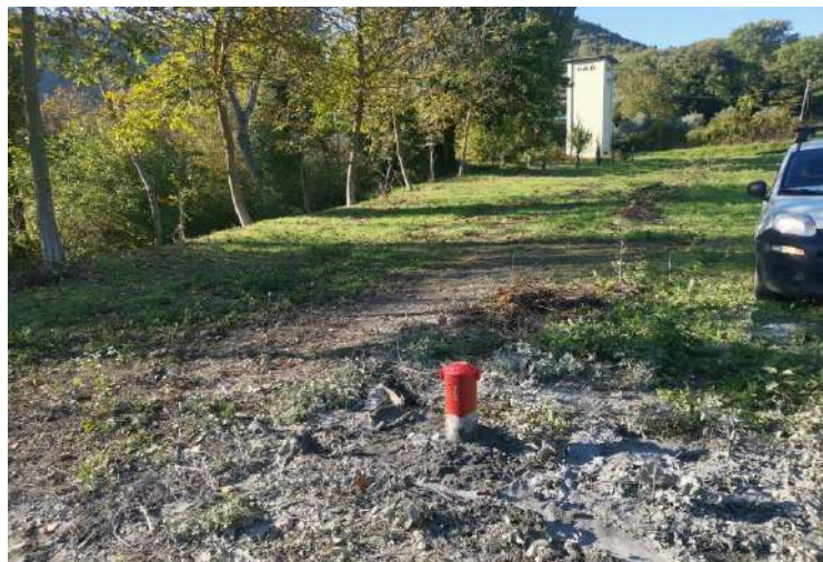
Chiusino fuori terra
