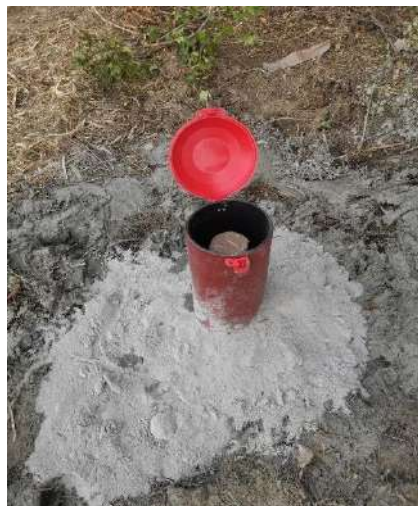
Chiusino fuori terra
