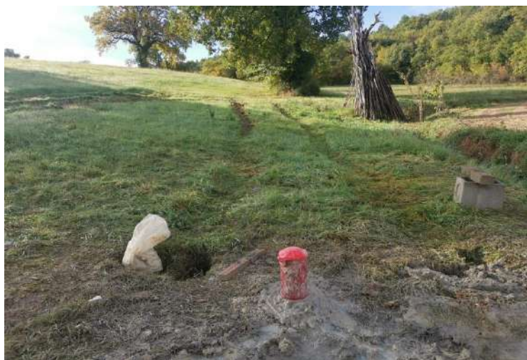
Chiusino fuori terra
