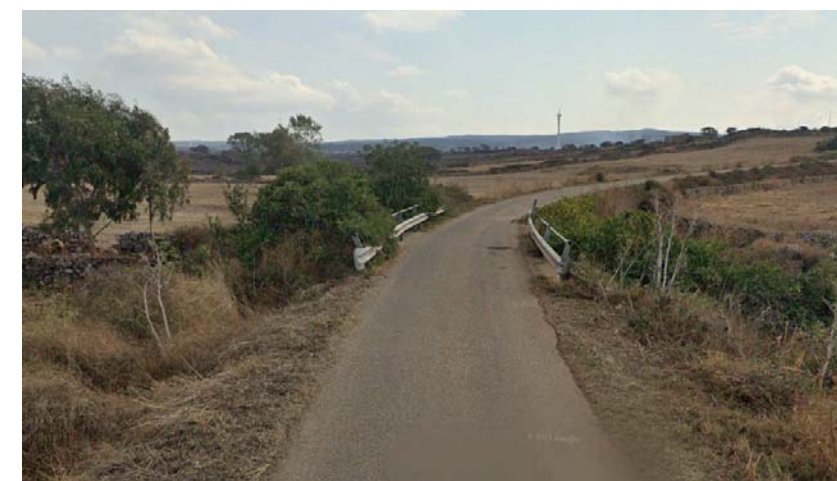
Figura 11: Cavidotto MT in TOC sulla Strada Sant'Albara a superamento dell'alveo torrentizio del Riu Su Coraggu
