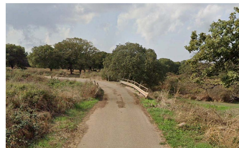
Figura 12: Cavidotto MT in TOC sulla Strada Sant'Albara a superamento dell'alveo torrentizio del Riu Cobercadas
