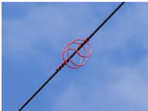
Figura 5 - Esempio di dissuasori per avifauna.
